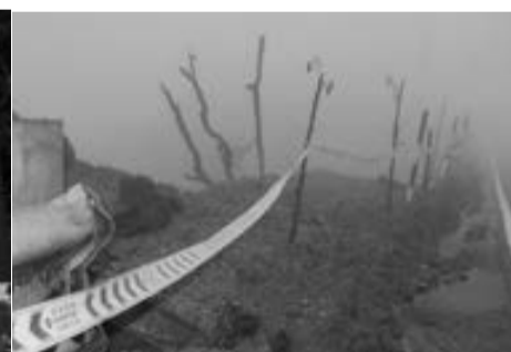
Một đoạn đường bị sạt, lở, kéo dài trên 20 m, đất, đá nằm ngổn ngang từ mặt đường đến chân đường (đoạn cách Đà Lạt khoảng 56 km).
