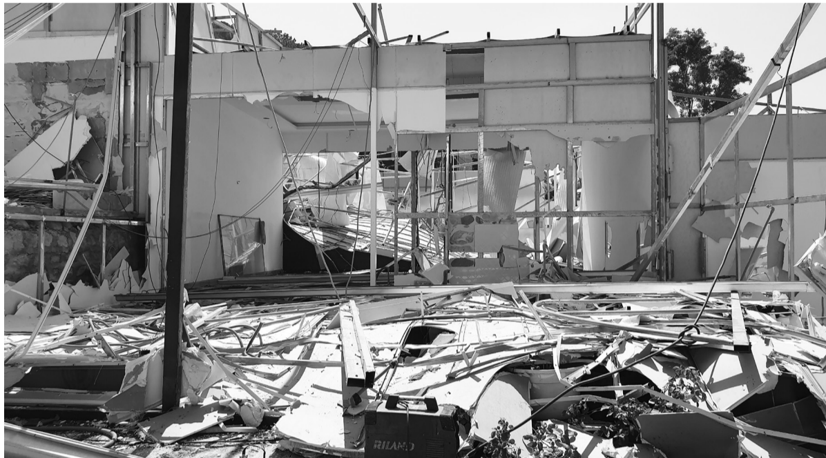
Hiện trường khắc phục tháo dỡ các công trình không phép tại Khu Du lịch Vườn Thượng Uyển bay ngày 4/5/2020.
