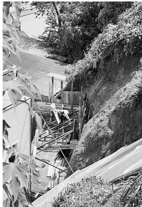
Kè chắn đất không phép phía sau nhà 10C Nguyễn Công Trứ.
