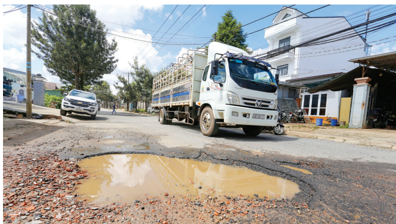
Nhiều đoạn trên đường Nguyễn Tử Lực đã xuống cấp nặng nhiều năm nay.
