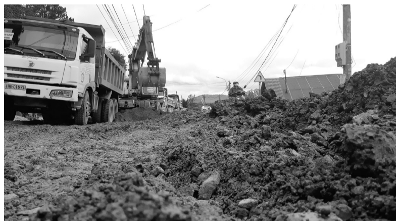
Đơn vị thi công cho khắc phục phần công trình thi công chưa đảm bảo chất lượng.
