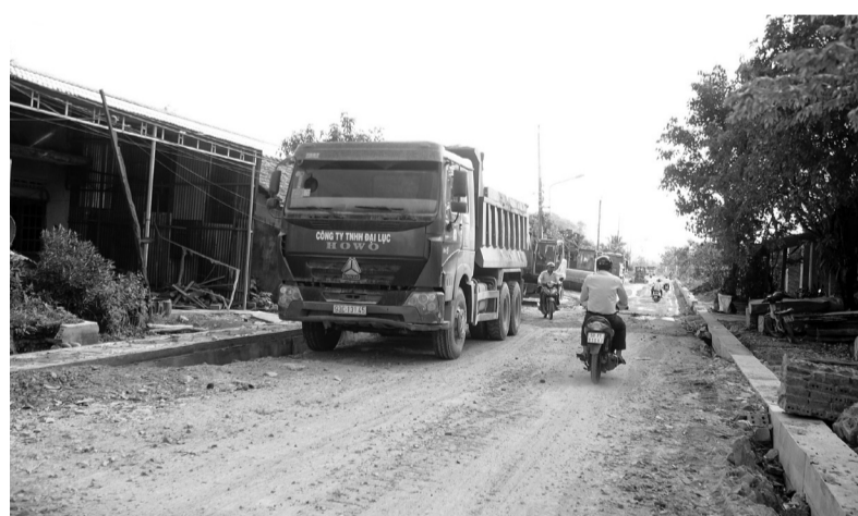
Các đơn vị thi công khắc phục mọi khó khăn, tranh thủ thời tiết nắng ráo để đẩy nhanh tiến độ các hạng mục công trình.
