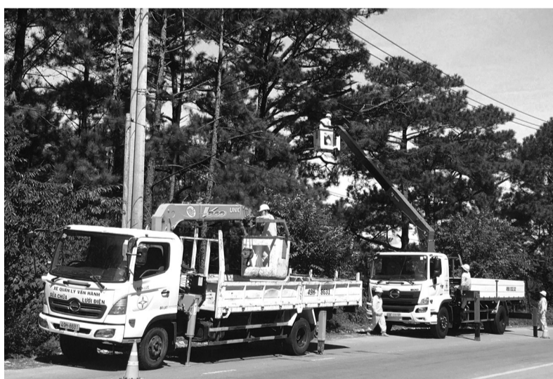
Cán bộ, nhân viên Điện lực Bảo Lâm thực hiện kiểm tra định kỳ về quản lý vận hành đường dây và trạm biến áp.
