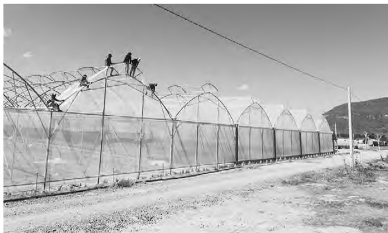
Công trình nhà kính của Công ty TNHH Nhà kính Nguyễn Thành, Đà Lạt có đường giao thông và hệ thống thoát nước tại xã Lạc Xuân, huyện Đơn Dương.
