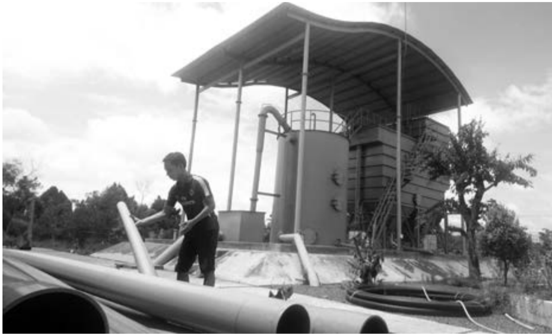
Hệ thống xử lý nước sạch Ghềnh Đá (xã Đức Phổ, huyện Cát Tiên). Ảnh: Đ.A
