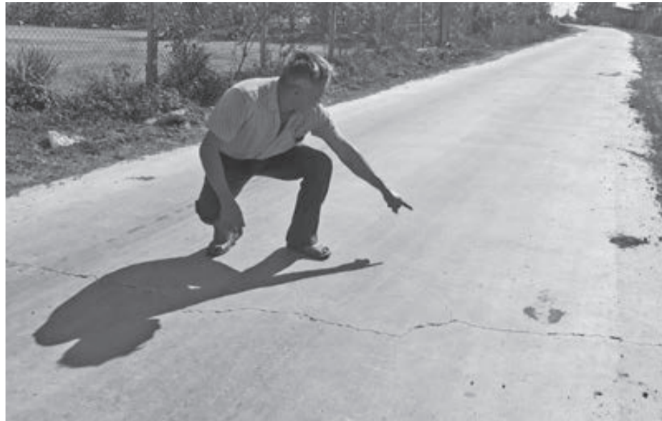
Tuyến đường nông thôn thôn Dạ Dâng đưa vào sử dụng được gần 3 tháng đã xuất hiện nhiều vết nứt chân chim.
