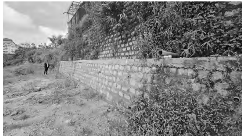
Công trình kè taluy không phép.
