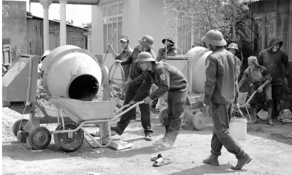
Lực lượng dân quân hỗ trợ bà con Nhân dân Thôn 5, xã Tam Bó, huyện Di Linh làm sân bê tông. Ảnh: V.Quỳnh
